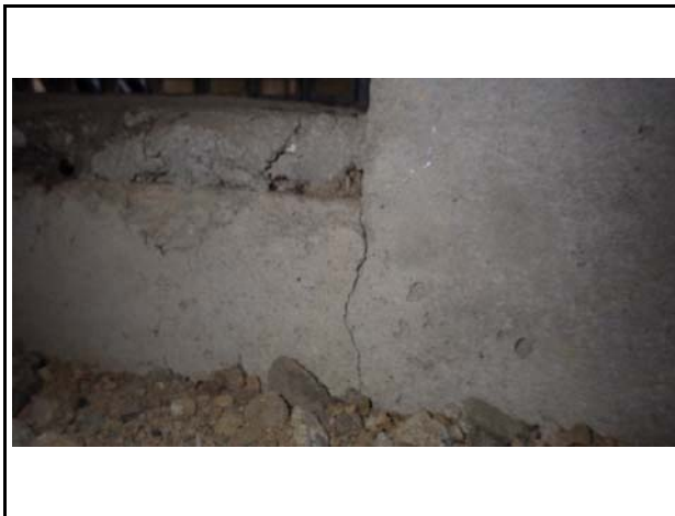
撮影箇所:20 クラック
