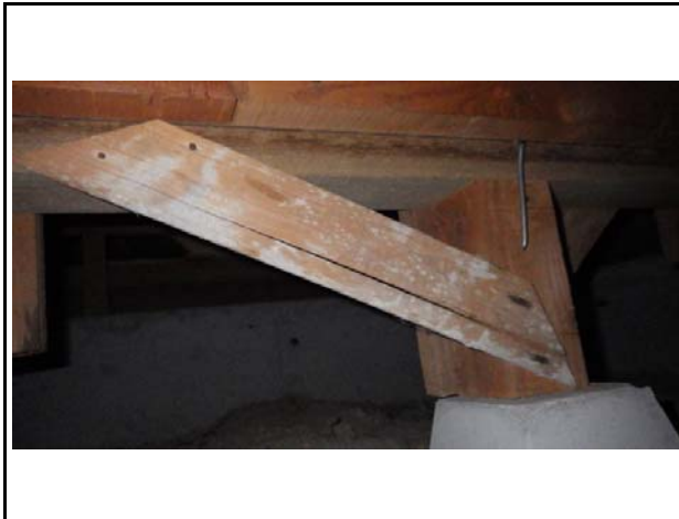
撮影箇所:18 カビあり
