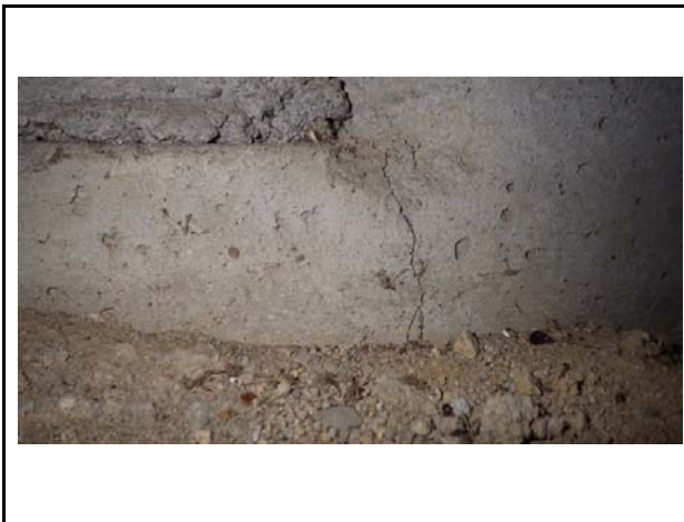
撮影箇所:19 クラック
